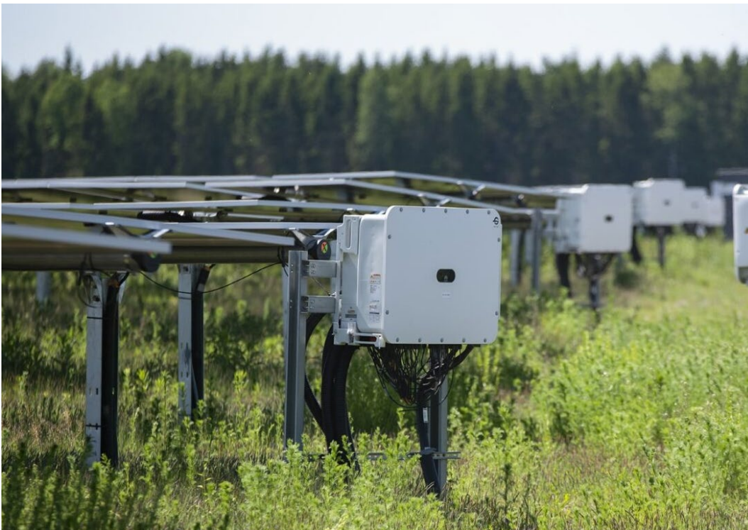
Figur 31-I en solcellspark med solföljare placeras växelriktarna vanligen i änden av solcellsrader och blir då grupperade i öppna korridorer. Se ovan exempelbild från solcellspark Lindesberg, Örebro län.
