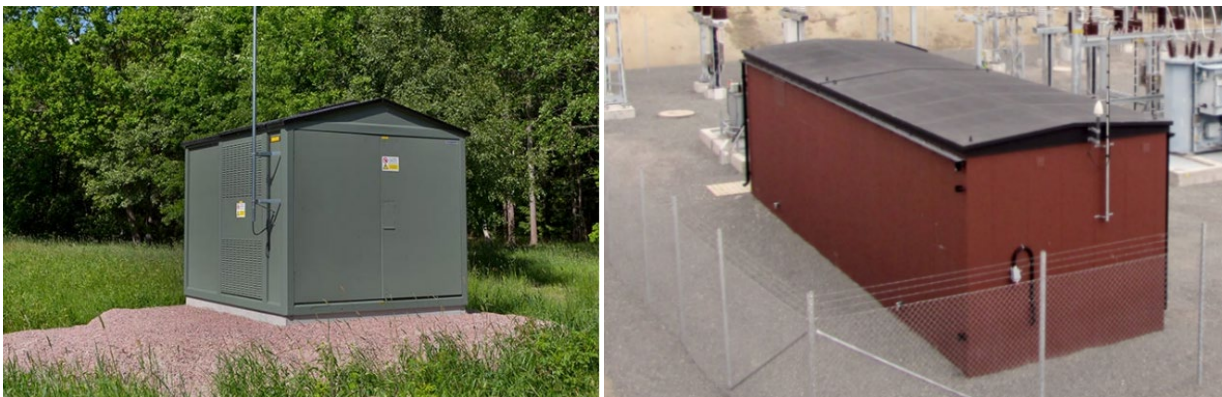
Figur 6. Exempel på transformator på markduk (till vänster). Exempel på ställverksbyggnad/kontrollbyggnad (till höger).
