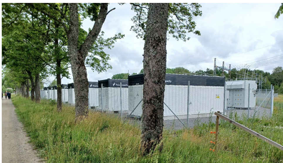
Figur 39. Exempel på batterilager i Västerhaninge. Containerar på rad. Till höger syns transformator.
