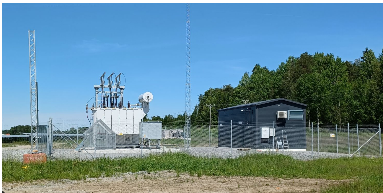
Figur 36-Exempel på ställverksbyggnad till höger och uteställverk med transformering till överliggande nät till vänster. Det är nätbolaget som normalt bygger och äger utomhusställverk. Utrymme för utomhusställverk ingår i tillståndsansökan.
