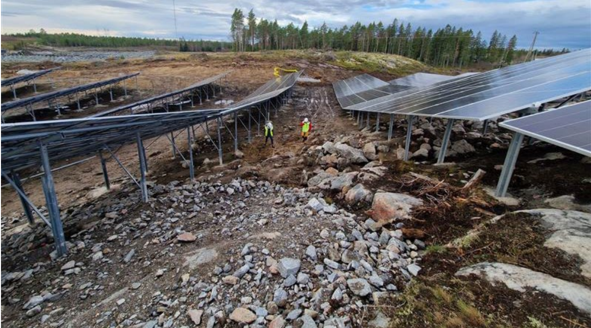
Figur 16. Solcellspaneler monterade i kuperad terräng. I förgrunden syns utfyllnad med material från projektområdet för att släta ut markprofilen i ett mindre område. I den här typen av mark kan det vara aktuellt med flera typer av grundläggning såsom bergförankring, nergrävning, förborrning och grävning och gjutning.
