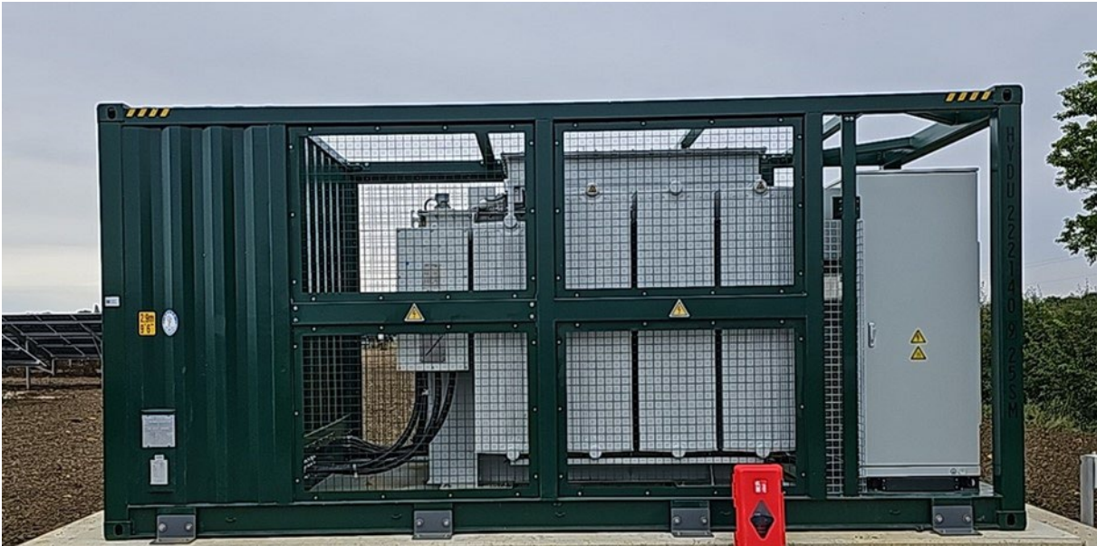
Figur 33-Exempel på transformator i containerutförande där transformatorn enbart skyddas av nät/galler.
