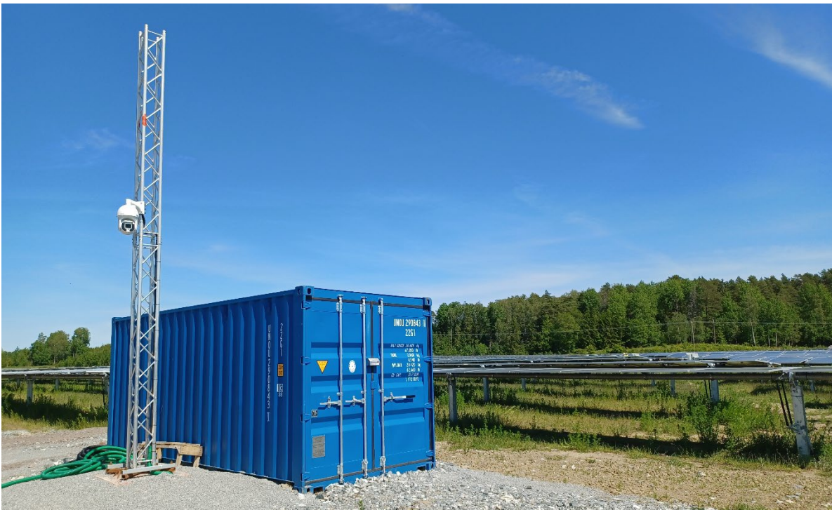
Figur 42. Exempel på lagringscontainer för reservdelar och material. Här har en övervakningsmast med kamera ställts upp invid den. I aktuellt projektområde bedöms flera lagringscontainrar ställas ut spritt i området.
