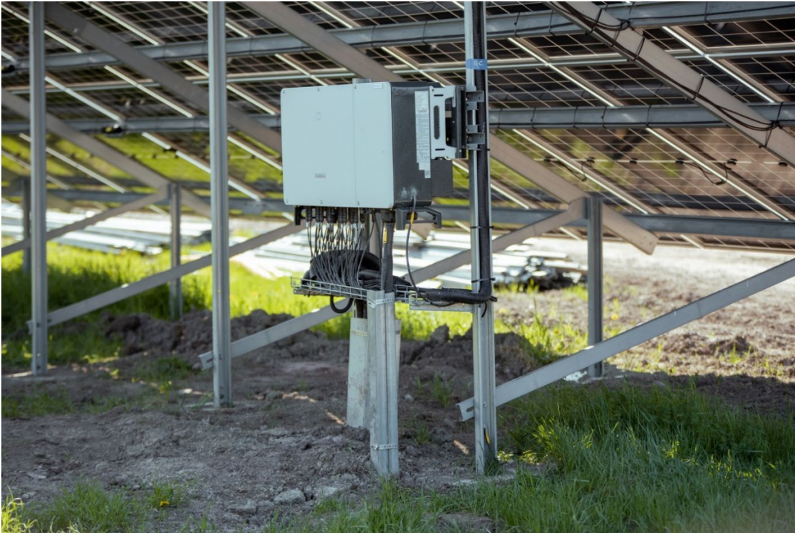
Figur 30-Exempel på växelriktare för konvertering av solcellsmodulernas likström till växelström. Här är växelriktaren placerad under panelerna och är då jämnt utspridda i parken. Växelriktarna kan också samlas i grupper för att betjäna ett visst antal paneler.
