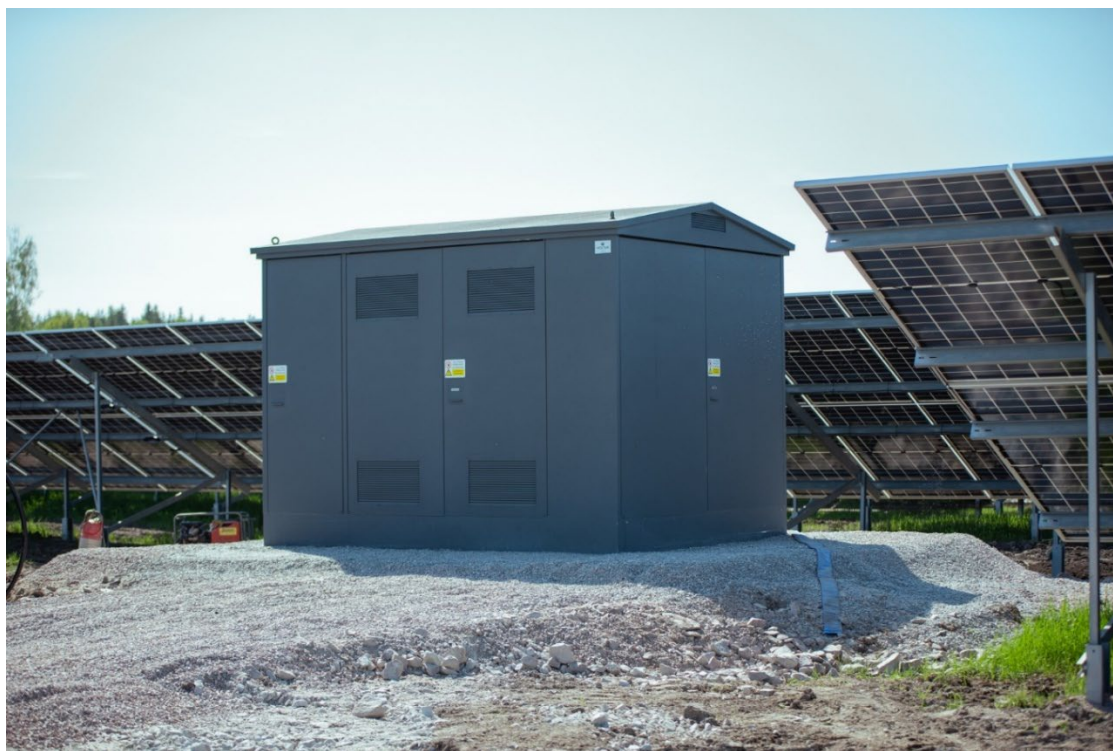
Figur 32-Exempel på mindre transformatornhet som placeras ut i parken. Helios Nordic Energy AB:s solcellspark Kungsåra.
