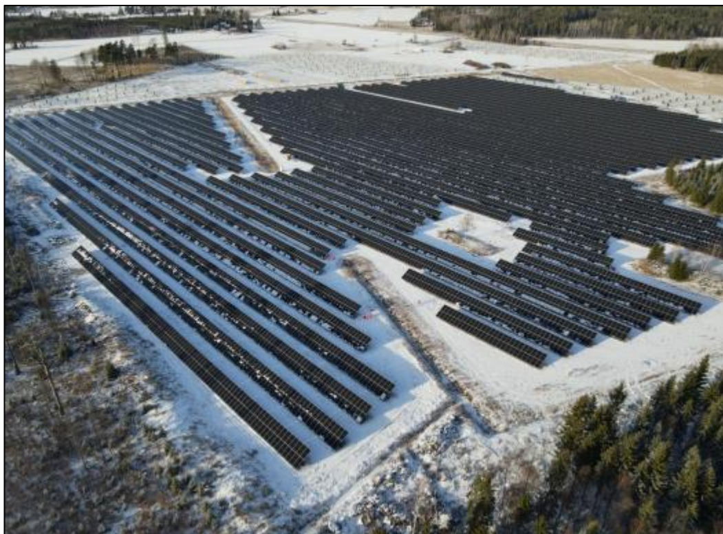
Figur 14. Exempel på byggnation och layout av solcellspark med fasta paneler (Foto: Helios Nordic AB).
