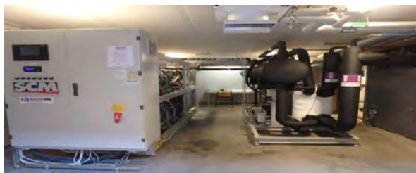
Ishallens nya kylmaskin
